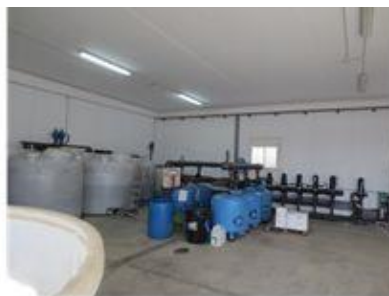
灌水用水の供給設備
